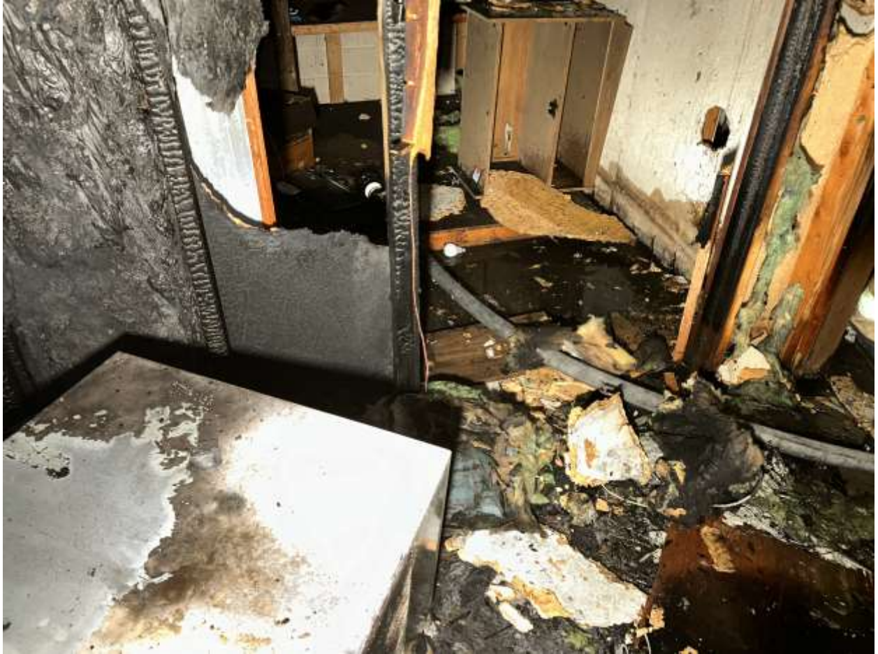
600 Hamline Ave N.Fire Photos
