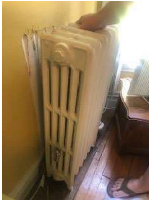
46: Loose radiator in tenant unit
