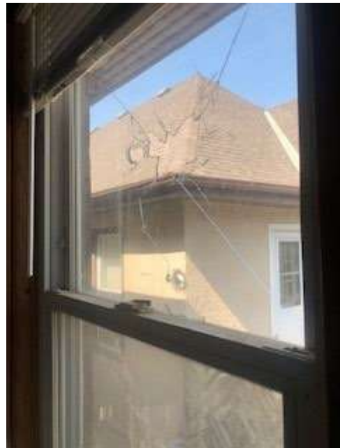
37: Hole in tenant window
