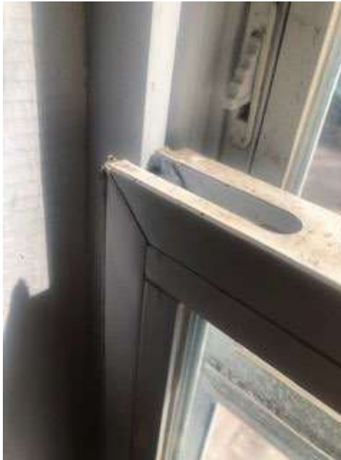
38: Tenant window off track
