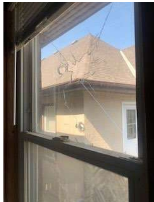
37: Hole in tenant window
