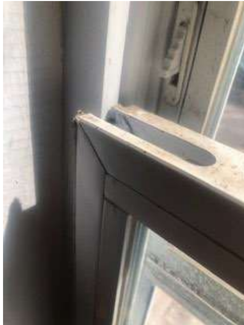
38: Tenant window off track
