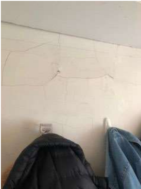
27: Wall cracks in tenant unit
