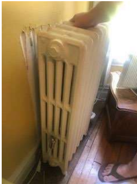
46: Loose radiator in tenant unit
