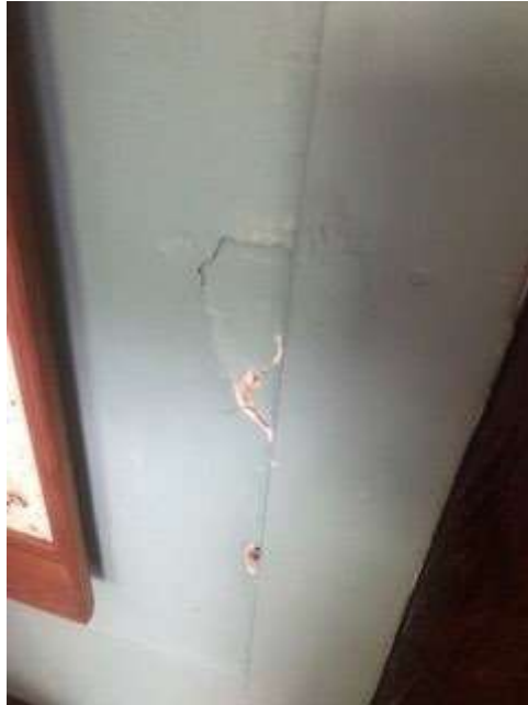
29: Wall cracks in tenant unit
