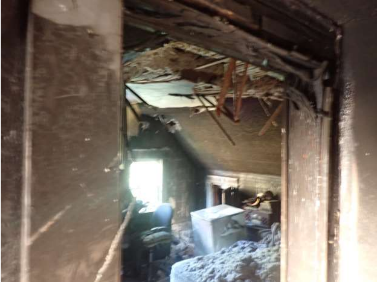
326 Charles Ave.Fire Photos 1-25-22 #2
