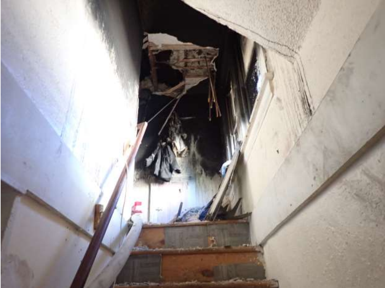
326 Charles Ave.Fire Photos 1-25-22 #2
