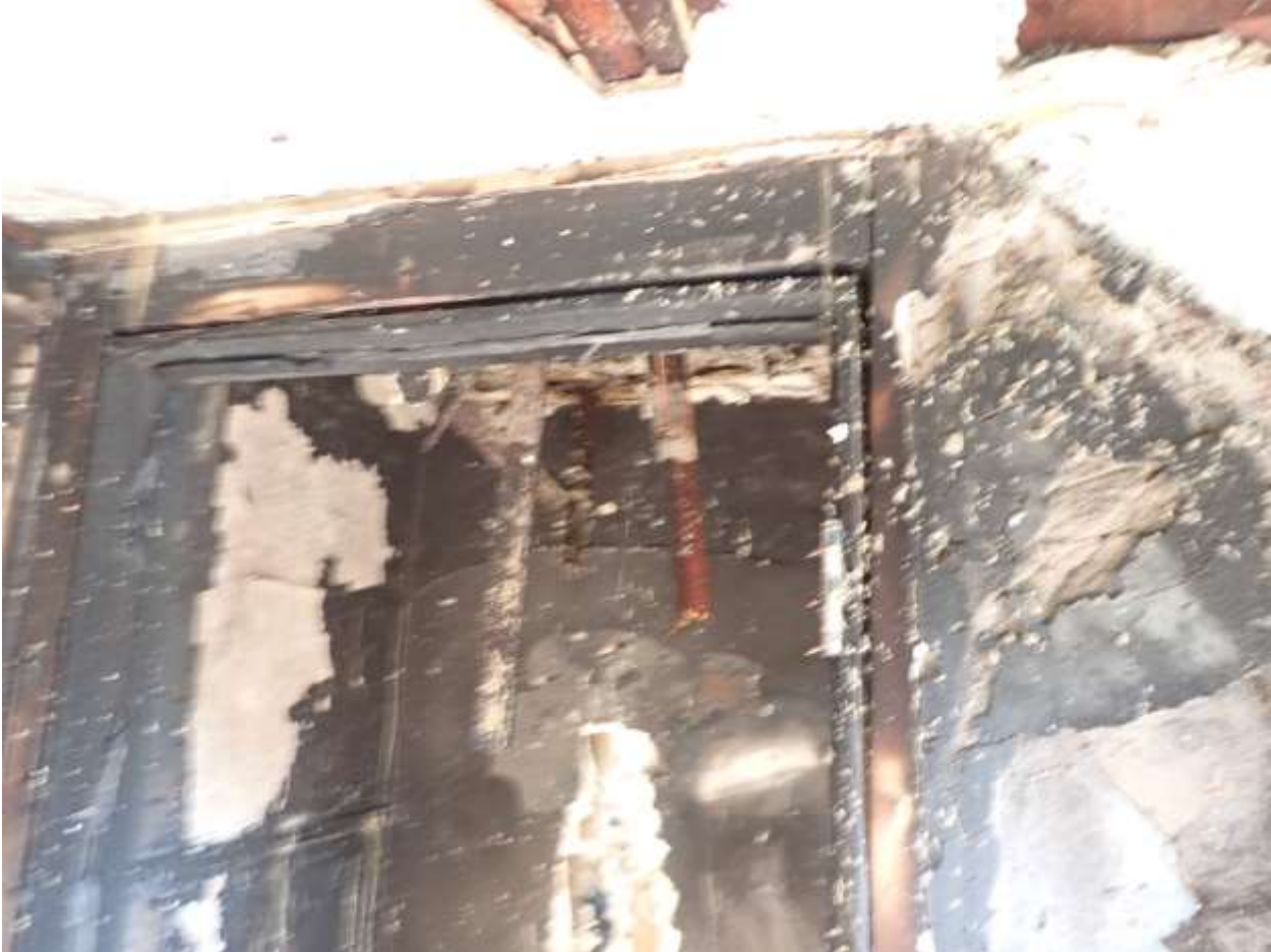
326 Charles Ave.Fire Photos 1-25-22 #2
