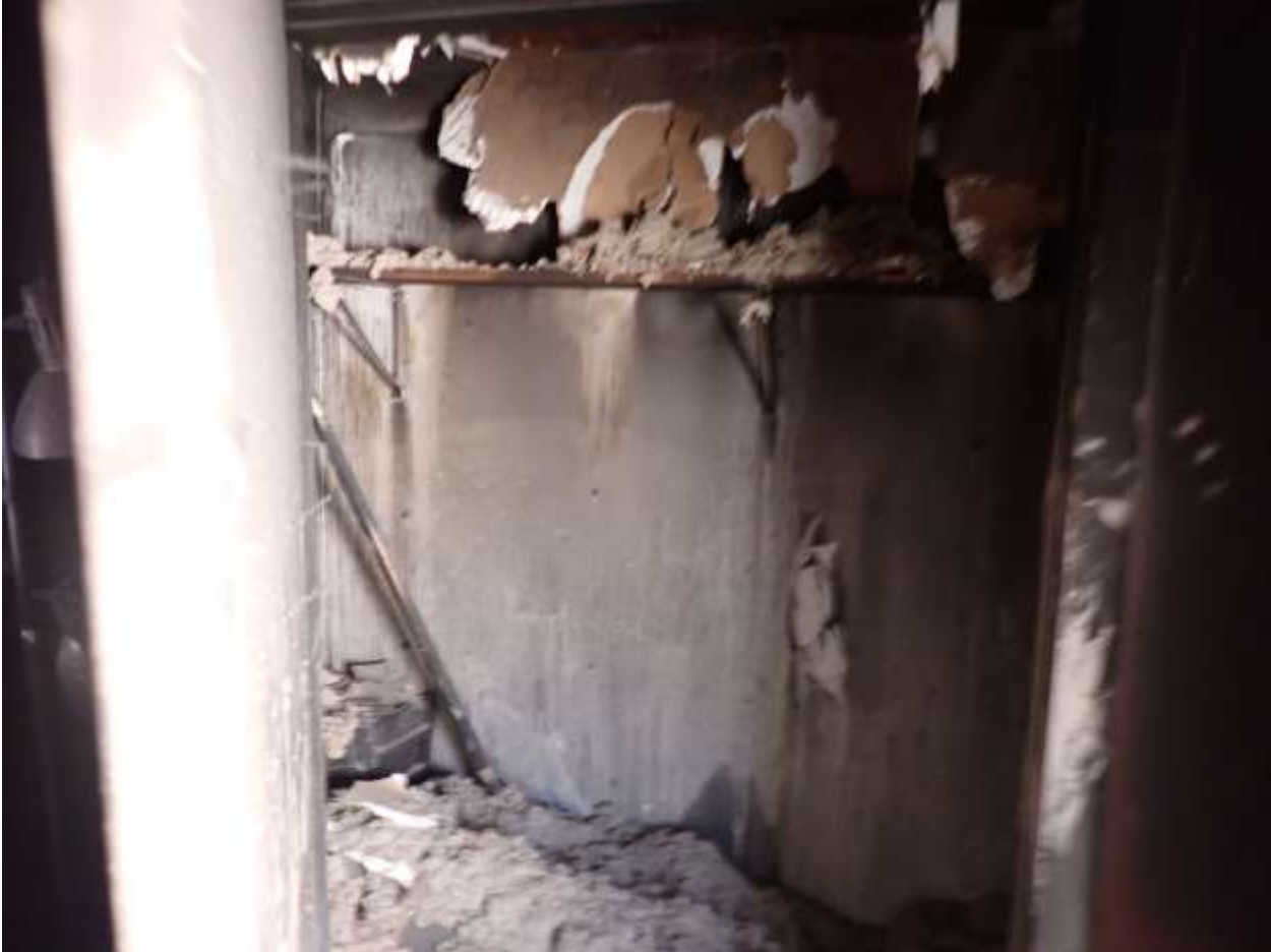
326 Charles Ave.Fire Photos 1-25-22 #2
