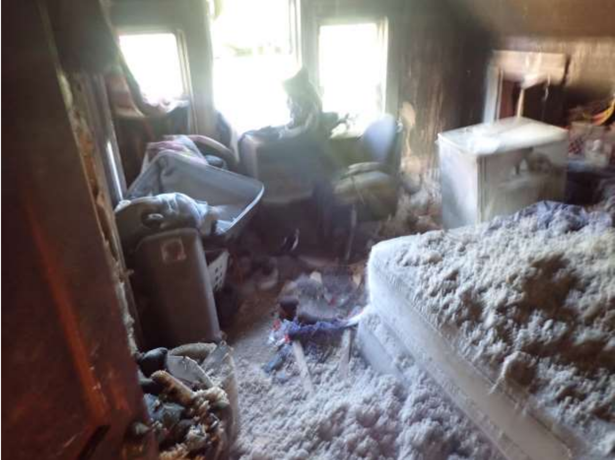
326 Charles Ave.Fire Photos 1-25-22 #2
