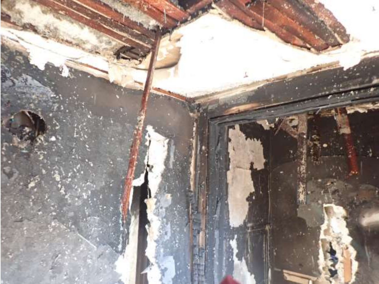
326 Charles Ave.Fire Photos 1-25-22 #2
