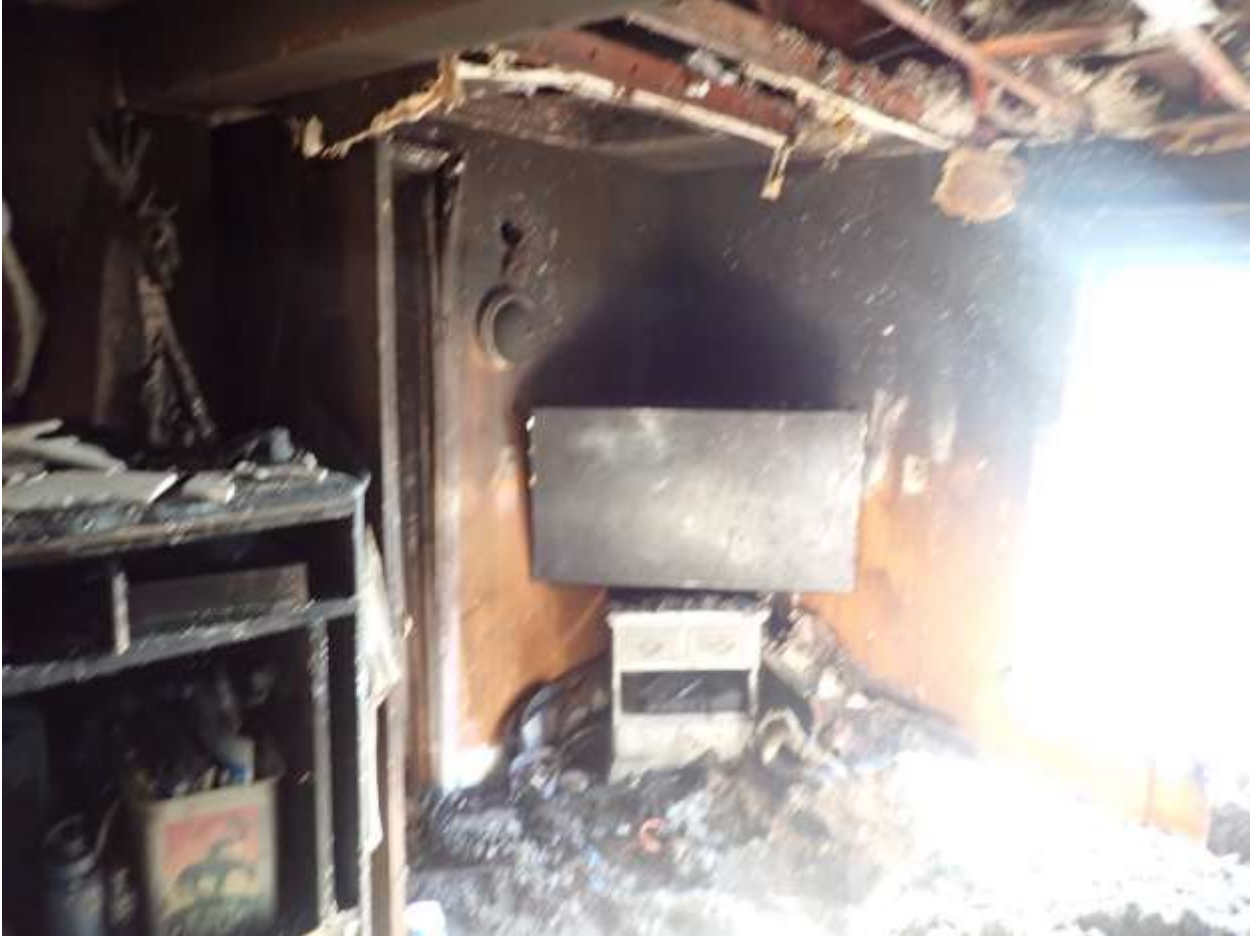
326 Charles Ave.Fire Photos 1-25-22 #2
