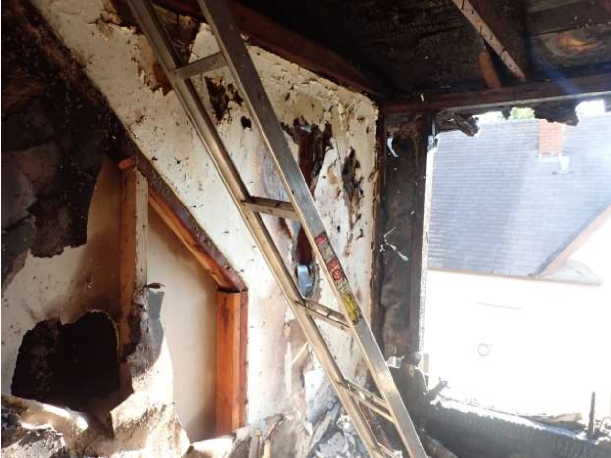
326 Charles Ave.Fire Photos 1-25-22 #2
