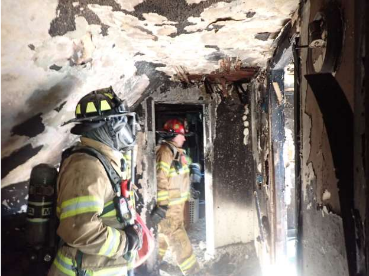
326 Charles Ave.Fire Photos 1-25-22 #2
