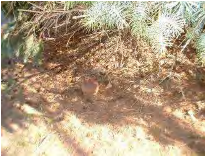
UST fill port
