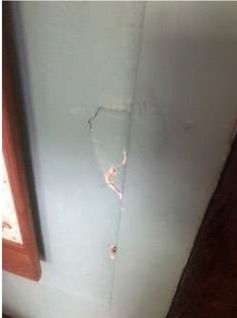
29: Wall cracks in tenant unit
