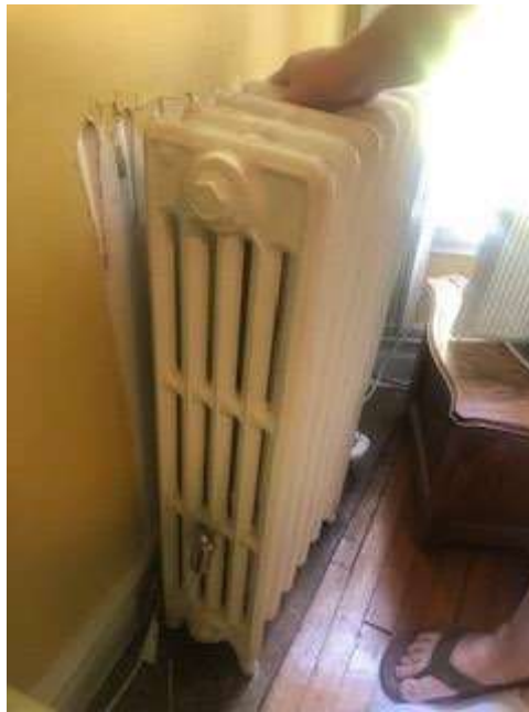
46: Loose radiator in tenant unit
