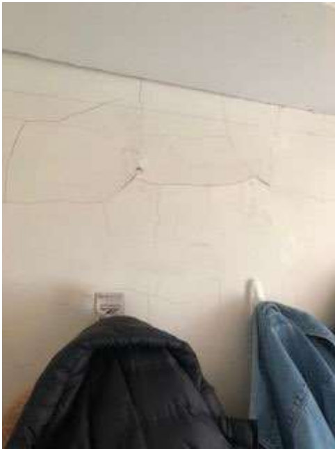
27: Wall cracks in tenant unit
