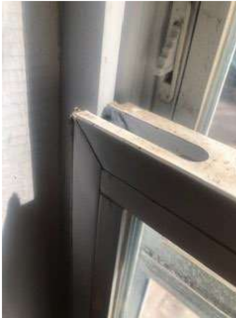
38: Tenant window off track
