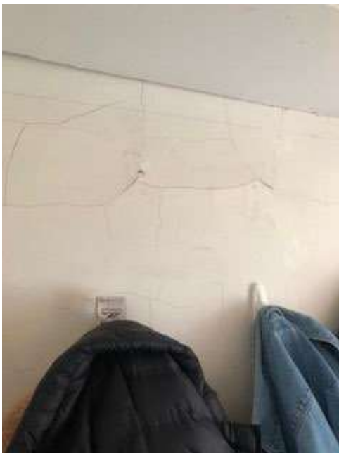
27: Wall cracks in tenant unit
